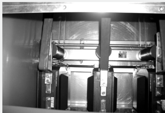
Рис. 26. Вид отсека сборных шин после демонтажа ревизионной панели
