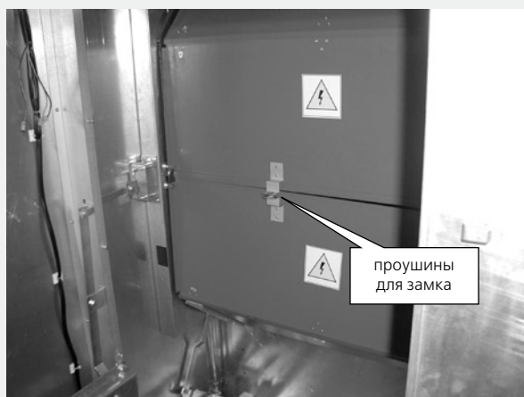
Рис. 8. Отсек выдвижного элемента при закрытых шторках
