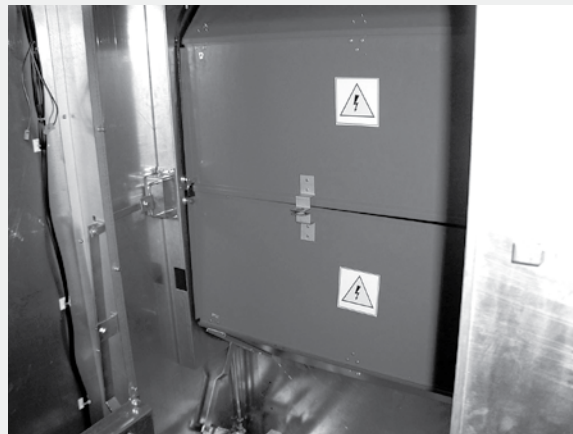
Рис. 3. Отсек выдвижного элемента при закрытом шторочном механизме
