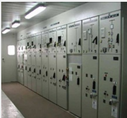
Рис. 3. Комплексное распределительное устройство трансформаторной подстанции в модульном электротехническом контейнере
