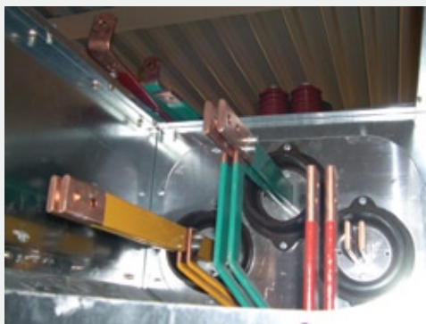
Рис. 6. Отсек сборных шин
