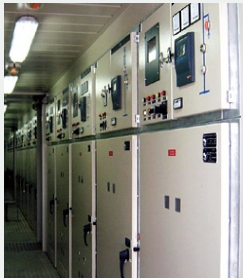
Рис. 4. КРУ в модульном контейнере
