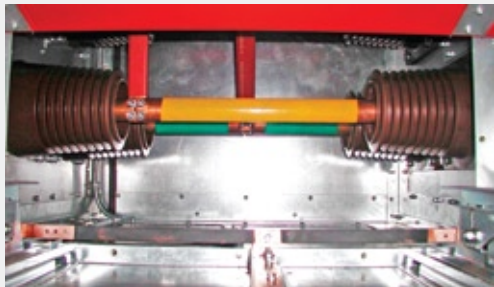
Рис. 6 Отсек сборных шин при снятой плите из отсека выдвижного элемента.
