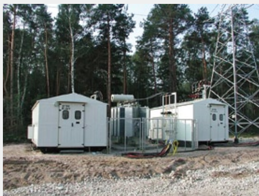
Рис. 2 Комплектная трансформаторная подстанция 35/10 кВ
