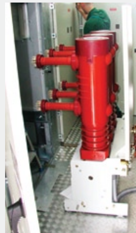
Рис. 10 Выдвижной элемент в ремонтном положении.
