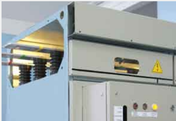
Рис. 5.2. Отсек сборных шин
