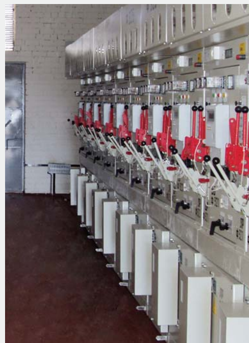
Рис. 10.2. Внешний вид смонтированного распределительного устройства
