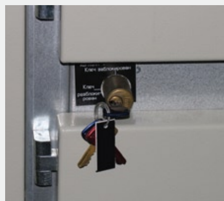
Рис. 20. Замковая блокировка вводного шкафа
