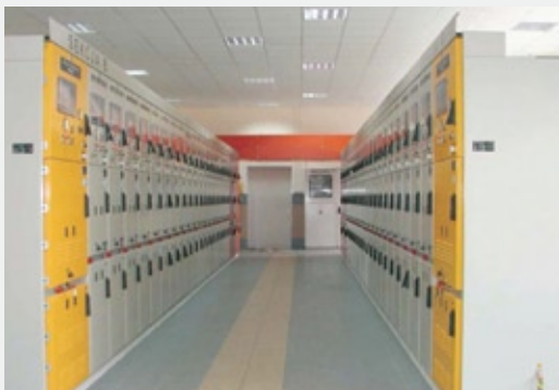
Рис. 1. Комплексное распределительное устройство электростанции
